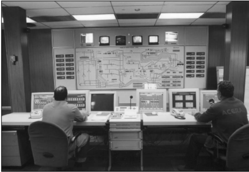
Panel de mando y control de parque de minerales
